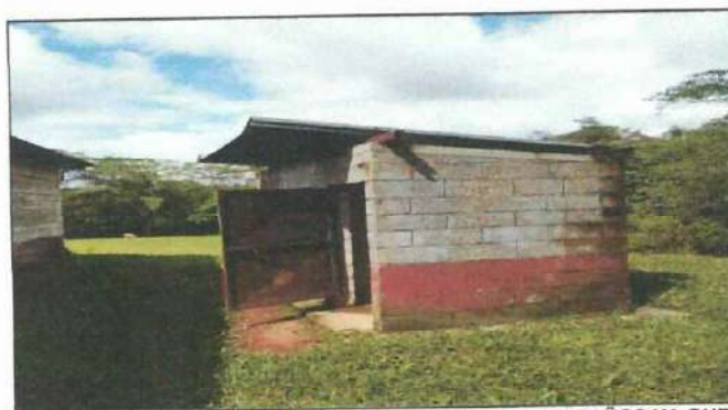
Foto 4: MANTENIMIENTO DE PINTURA DE PAREDES DE BAÑOS YA QUE SE ENCUENTRAN EN MAL ESTADO
